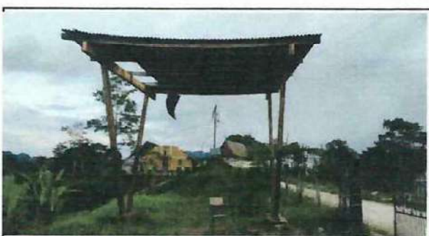
foto No. 6: Estructuras y laminas en mal estado.
