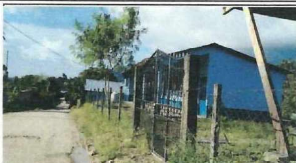
FOTO No. 2: Mallas en mal estado del establecimiento
