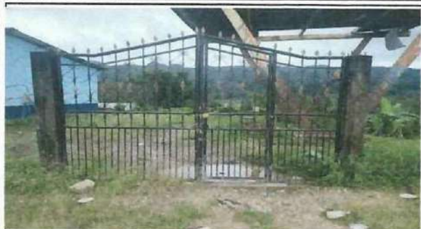
FOTO No. 1: Circulación del predio rotos, oxidados y en mal estado.
