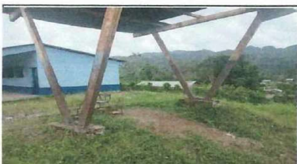
FOTO No. 4: Las bases y las estructuras metálicas oxidadas y en mal estado.
