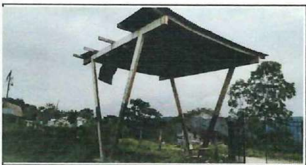
FOTO No. 5: El techo del escenario rotos, despegadas de las costaneras.
