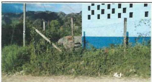
FOTO No. 3: Los postes y alambre oxidado y en mal estado.
